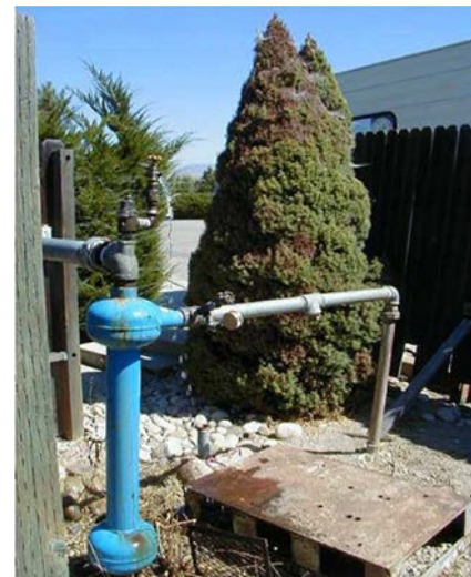
Figura 1: La boca de pozo en su propiedad típicamente incluye un tubo que va a su tanque de presión.
